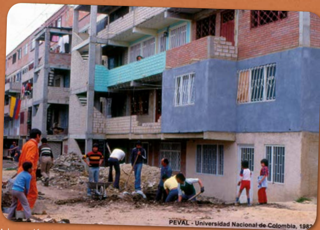
Adecuación de vías del proyecto de vivienda Ciudad Bachué en Bogotá PEVAL, Tova Solo, 1983.
